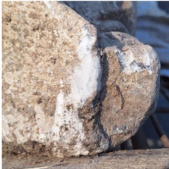
Zone de pulvérulence sur la partie inférieure du banc côté dextre
