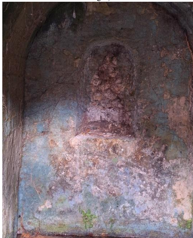
Couche bleu vert repérée sur les murs du petit oratoire
